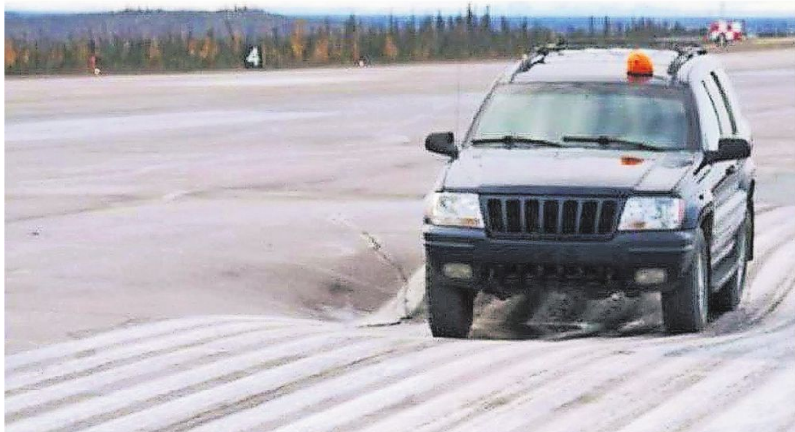
Im kanadischen Inuvik haben auftauende Bodensetzungen zu starken Beschädigungen der Landebahn geführt.
